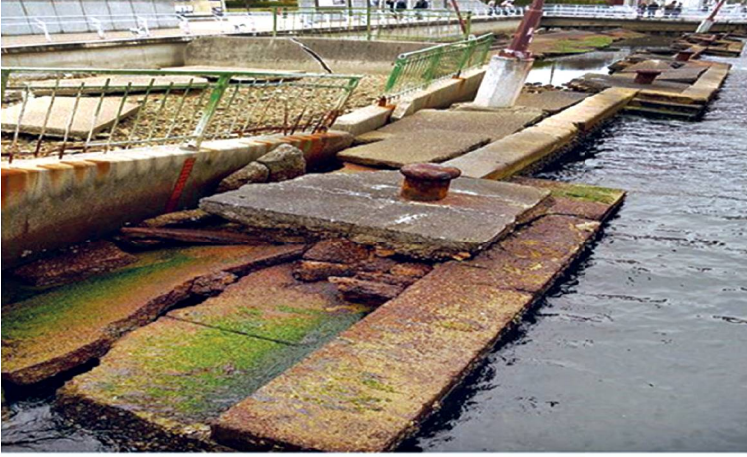
Şekil 1. Deprem nedeniyle kıyı yapısında meydana gelen deformasyon.
